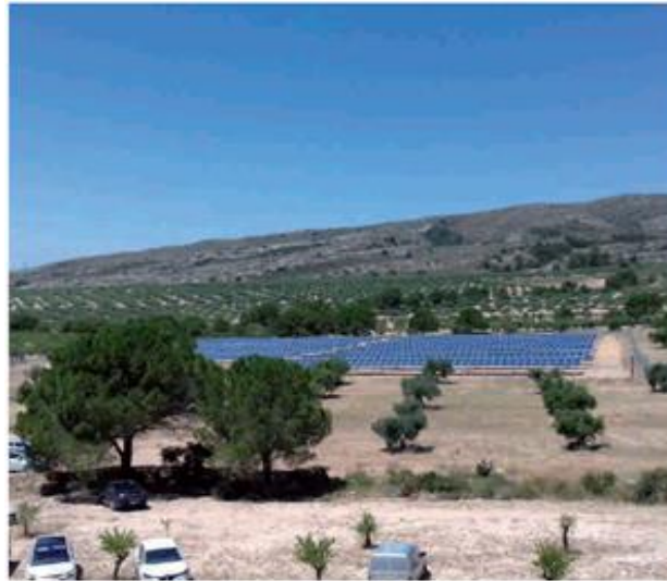
Placas solares, sistema de riego Villena.
